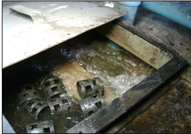
รูปที่ ๑๓ ระบบบำบัดน้ำเสียแบบบ่อกรองเติมอากาศ
