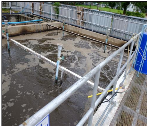
บ่อเติมอากาศ
