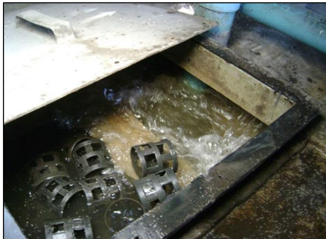
รูปที่ ๑๑ ระบบบำบัดน้ำเสียแบบบ่อกรองเติมอากาศ
