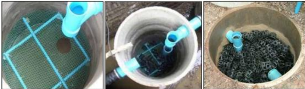
ระบบบำบัดน้ำเสียแบบบ่อกรองไร้อากาศ
