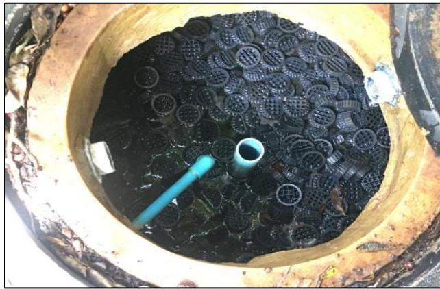
รูปที่ ๑๐ ระบบบำบัดน้ำเสียแบบบ่อกรองไร้อากาศ
